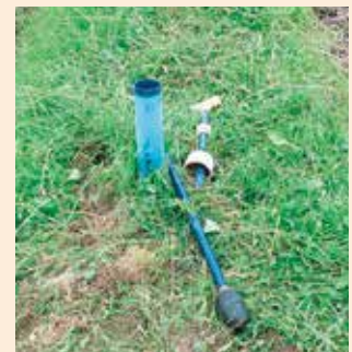
③ 水閘の破損
