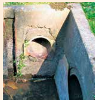
① 水口工の破損
