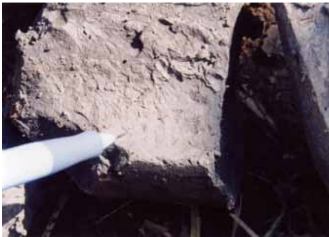
写真-1 アンカー孔壁の粘土化状況
