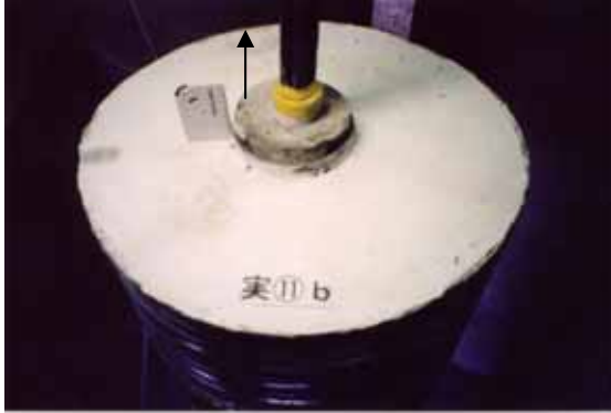
写真 - 6 摩擦型アンカー引抜け状況
