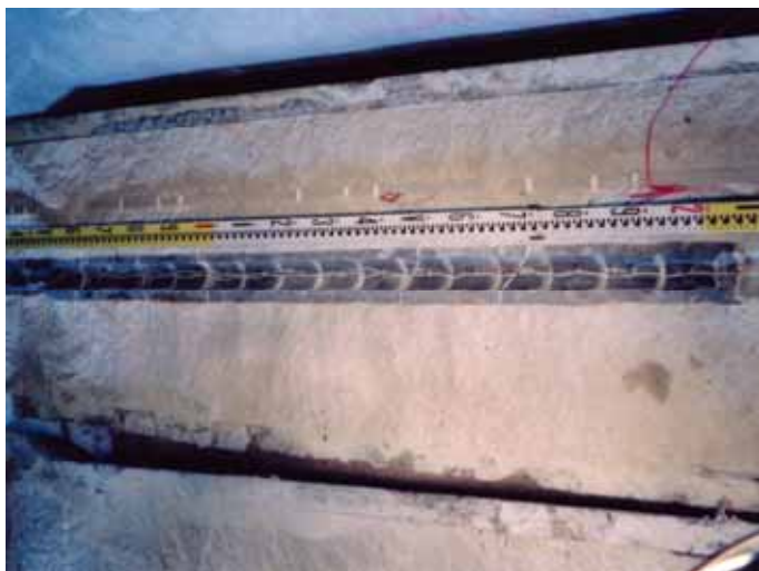
くさび型アンカー体のクラック状況(引張りキレット間隔20cm、まさつ型に比し安定している)
