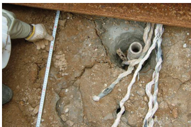
写真-9 引張型アンカー体引抜けにともなう地表の盛り上がり状況 (図-29 (A))
