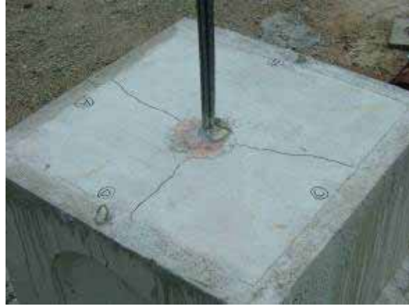
写真 3.10 溜め桧の破壊（700kN 時）
