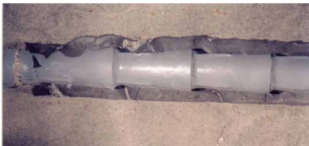
写真 2.14 拘束具引抜け状況
