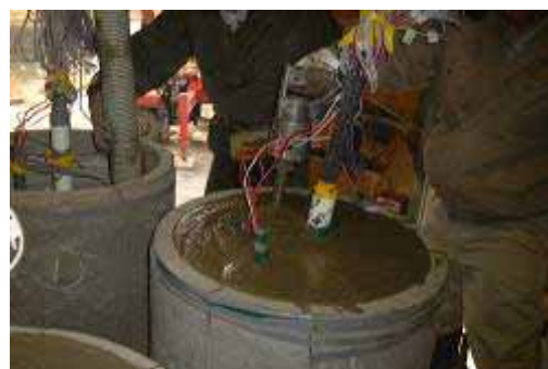
写真 2.12 ヒューム管内にアンカー体と歪計を設置後、モルタル充填
