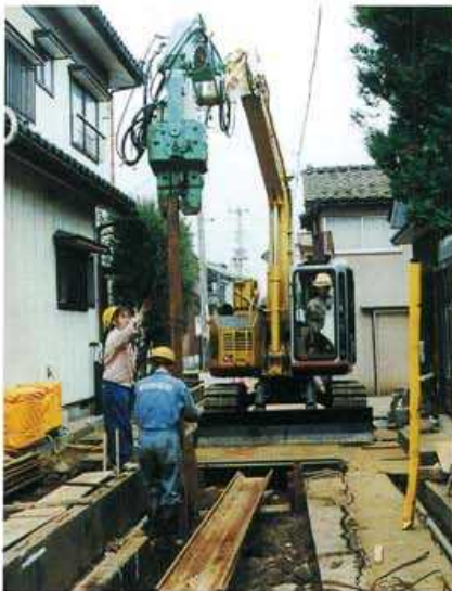
PALSONIC-2B 新潟県三条市役所 下水道課 下水道枝線工事 軽量鋼矢板Ⅲ型-4.5m ベースマシン:0.2㎡ 土質:砂 N値:8
